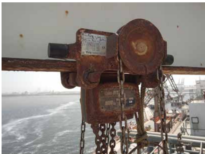
Corrosion sur un Yalelift avec chariot intégré – toujours fonctionnel après 9 ans d'utilisation
